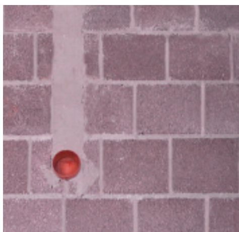
Parete divisoria con ponte acustico dovuto alla presenza di cavedio impiantistico.
