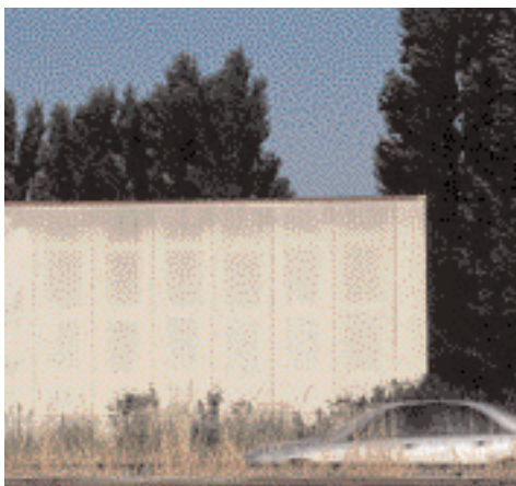
Effetto causato dai ponti termici e dalla condensa nei pannelli di tamponamento prefabbricati a "sandwich".
