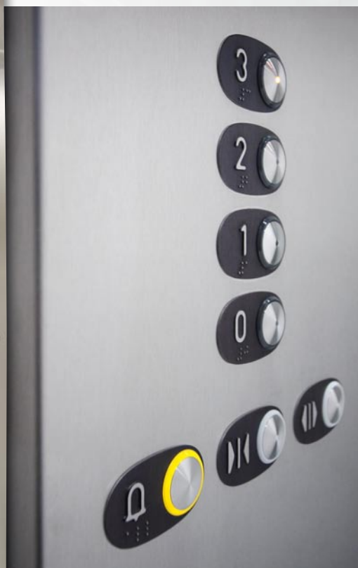
BOTTONIERA DI CABINA
