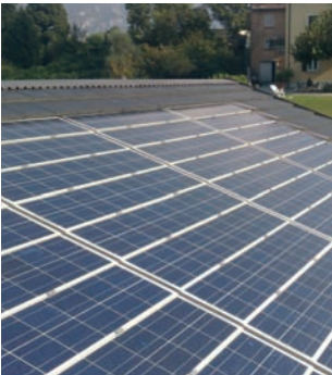
Bellagio (CO) - Abitazione privata Potenza dell'impianto: 2,952 kWp.
