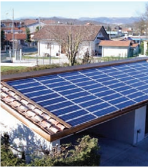
Ceccano (FR) - Abitazione privata Potenza impianto: 6 kWp.
