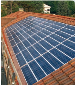
Carnate (MB) – Abitazione privata. Potenza impianto: 6 kWp.
