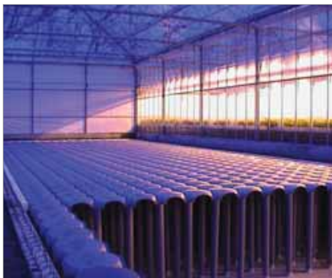
Vasca di accumulo acqua in una sera
